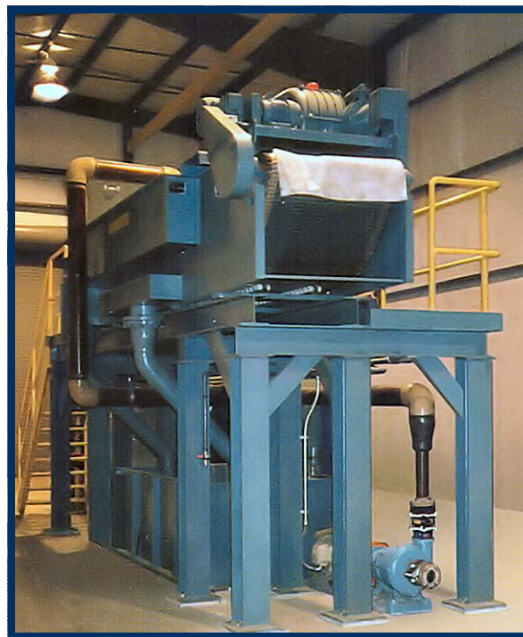
F-750 mostrato presso l'impianto di un cliente mentre filtra acqua contaminata da un pozzo caldo di fresa
