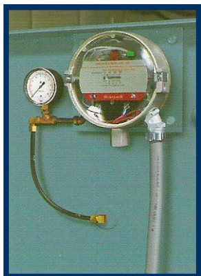
Interruttore del vuoto
